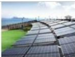
太陽能電站工程
